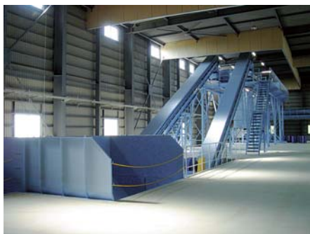
同工場 内観(機械設備)
