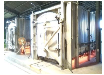
設立当初の2基から4基に増設した窯炉
